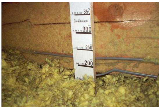
(200mmで施工のところ約160mmに沈下)
